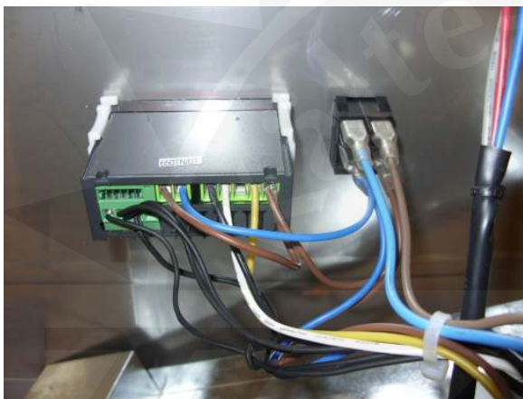
Verkabelung Thermostat VOR dem Umbau
